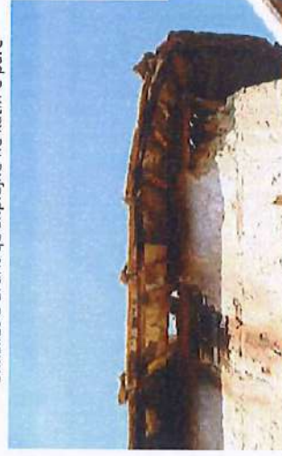
Dëmtimi në konstruksionin e kulmit dhe mbulesën
