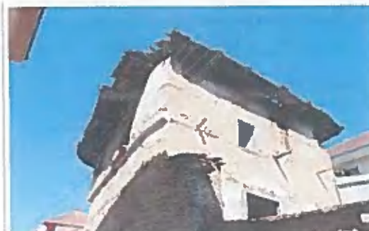
Dëmtimet në konstruksionin e kulmit
