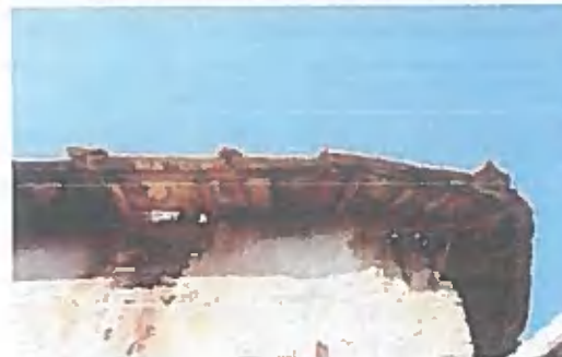
Dëmtimi në konstruksionin e kulmit dhe mbulesën
