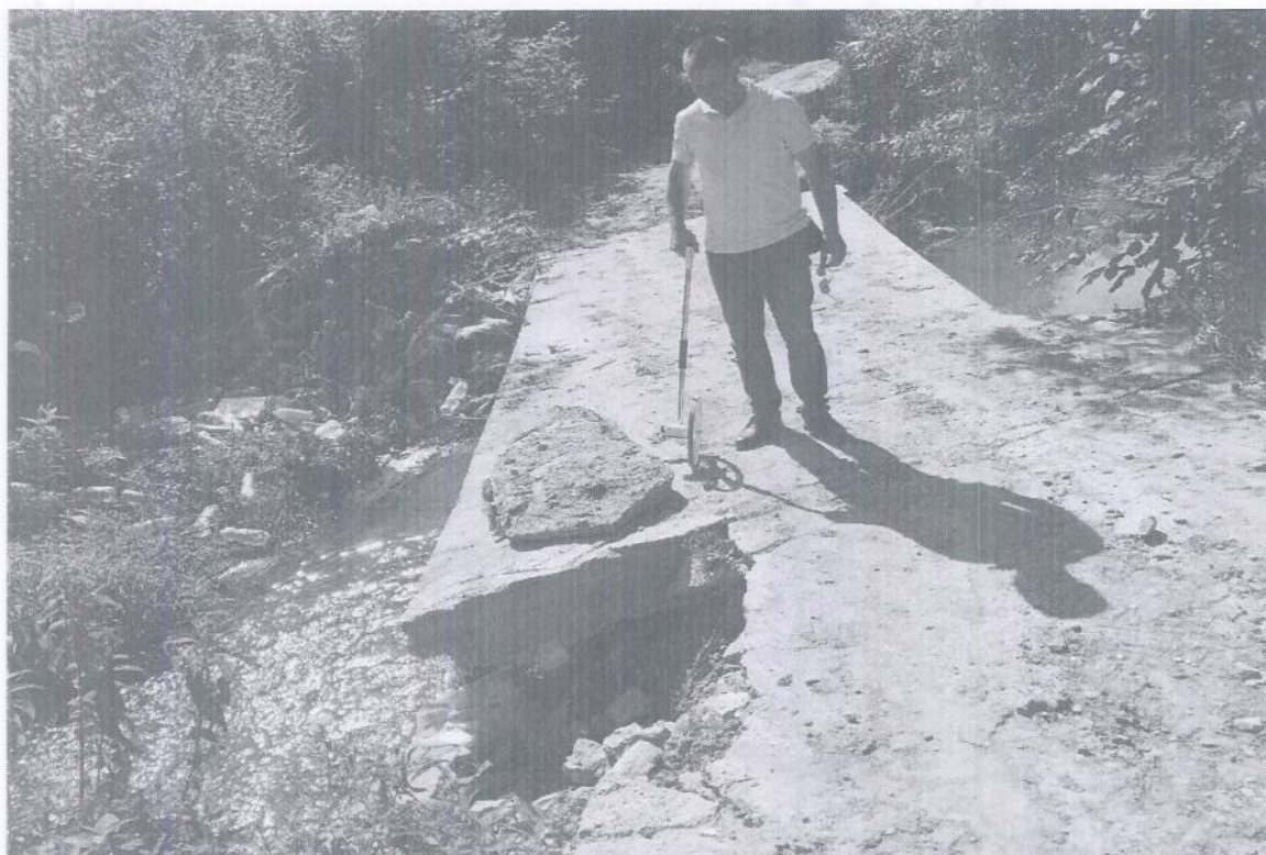
Dëmtimi i urës mbi përrockë dhe dëmtimi i rrugës.
