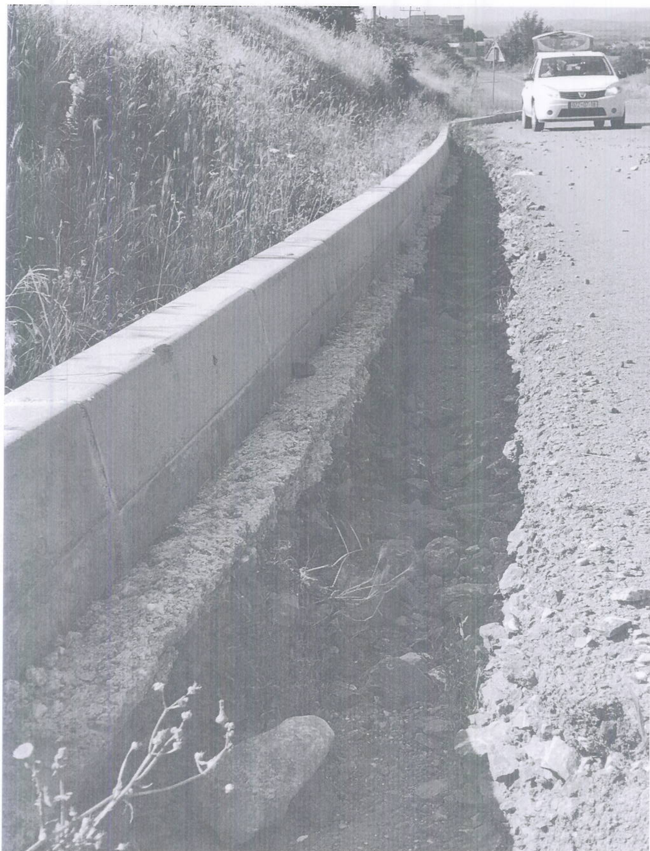
Dëmtimi i rigolës dhe bankinës në rrugën e asfaltuar.
