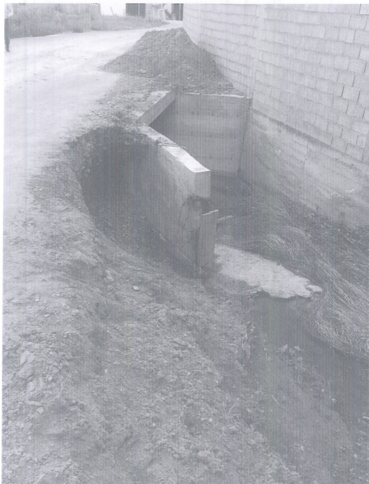
Erozioni i zhavorit tek shpatullat e urës dhe tek bankinat.
