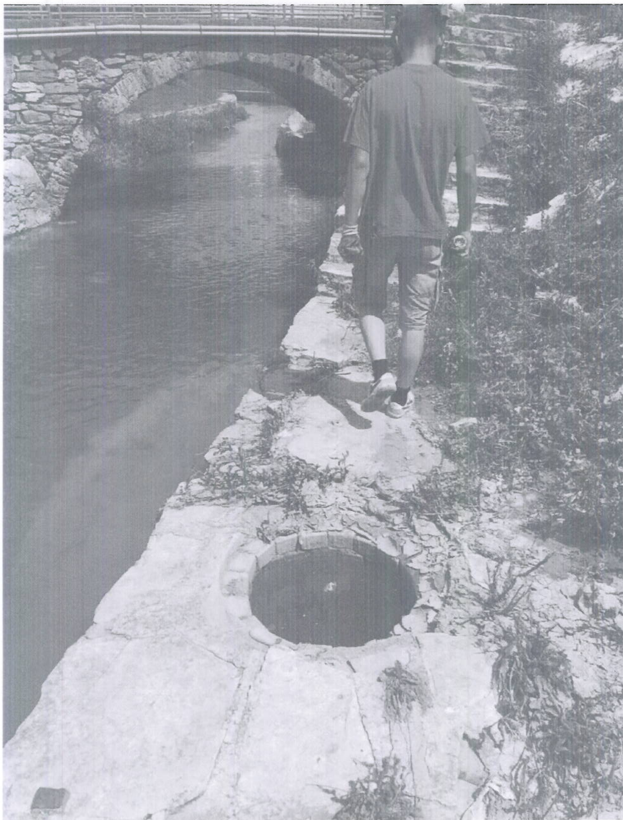
Mbyllja dhe bllokimi i pusetës dhe kanalizimit fekal nga vërshimet.
