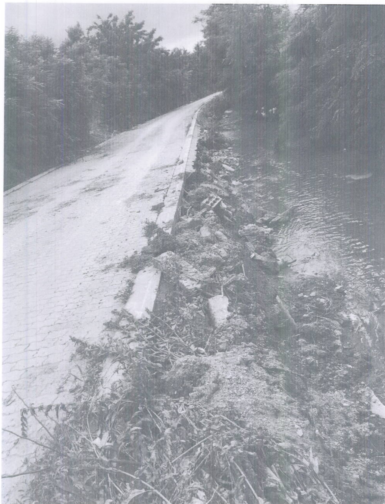
Dalja e ujit nga shtrati i prockës në rrugë dhe erozioni i bankinave të rrugës .
