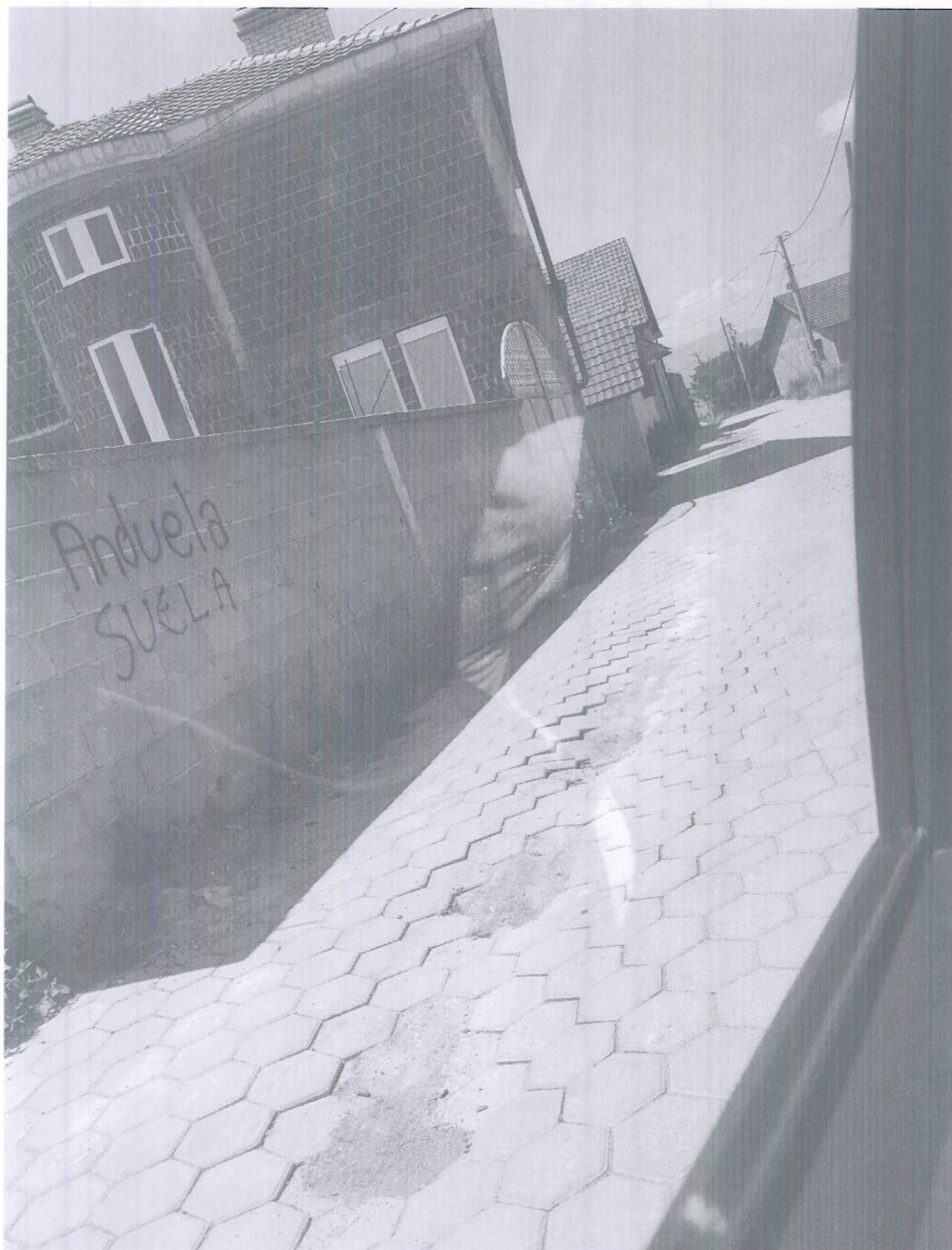
Dëmtimi i trupit të rrugës me kubëza si shkak i vërshimeve.
