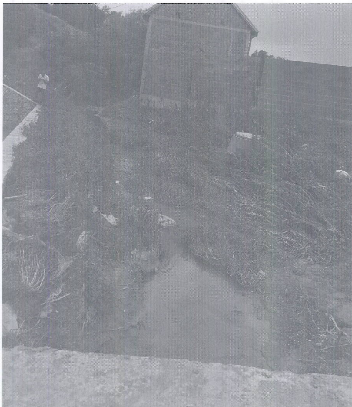
Mbushja e përrockes dhe kanalizimit fekal me mbeturina të shkaktuara nga vërshimet
